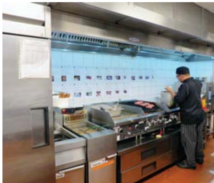
Los equipos Rational son de gran utilidad en la operación y versatilidad de la cocina de AC Hotel.
